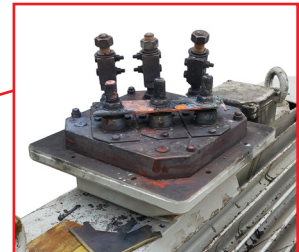
Défaut défaillance de contact
