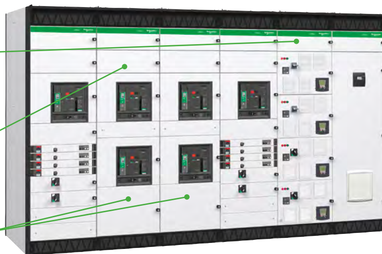
TGBT de forte puissance Okken
