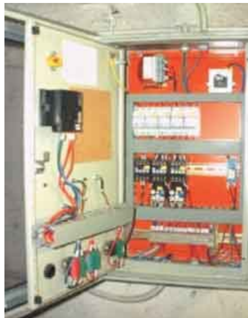
Interno del quadro di una centrale termica
