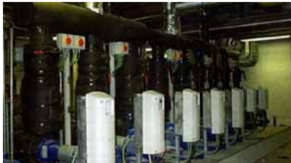
Fig.3: Inverter installati su pompe. La soluzione in IP54 permette di eliminare la necessità di inserimento dell'inverter in un quadro
