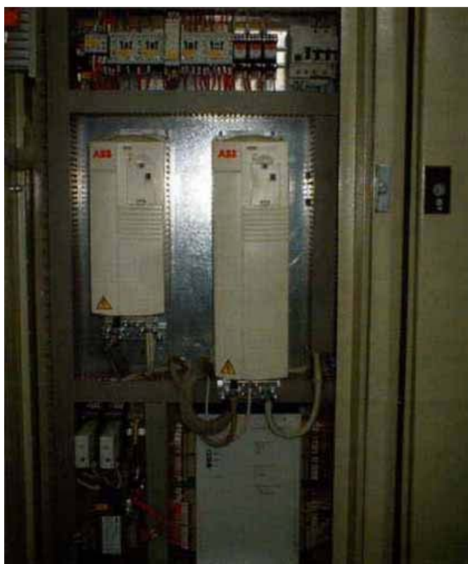
Fig.4: Inverter installati in quadro per controllo di una UTA. La portata dei ventilatori di mandata e ripresa è regolata in base alla reale domanda dell'impianto garantendo la massima efficienza energetica
