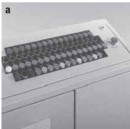
Fig.17a: Leggio di un quadro elettrico con pulsanti, selettorie e lampade di segnalazione. Si noti sulla destra il pulsante a fungo del comando di emergenza
