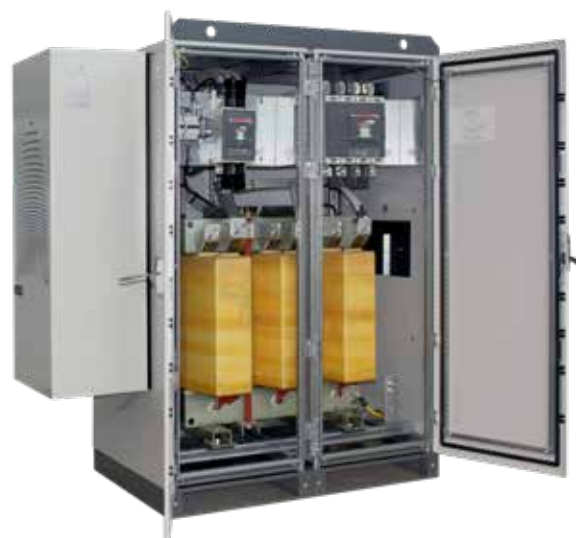
Trasformatore in cabina IP54 con interruttori magnetotermici e condizionatori.
