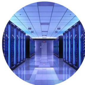
Data Center Noviglio
