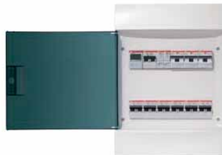
Protezione Centralino di distribuzione moderno
