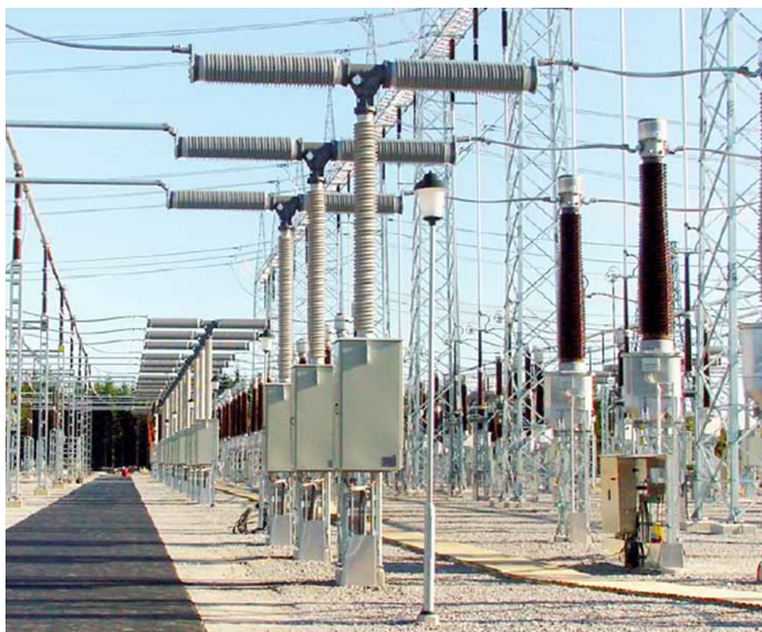
Figura 6: interruttore sincrono in una sottostazione a 420 kV
