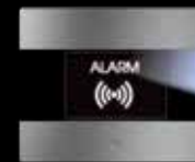
Segnalazione ALARM ALARM signal
