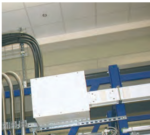
Canalis KS e sprinkler.
