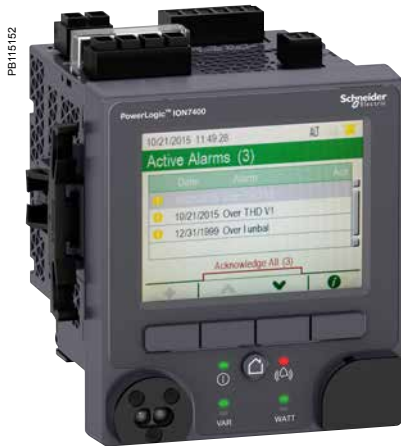
Misuratore PowerLogic ION7400 con allarmi attivi.
