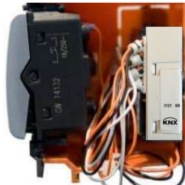
Sezione di una scatola con interfaccia collegata a pulsante
