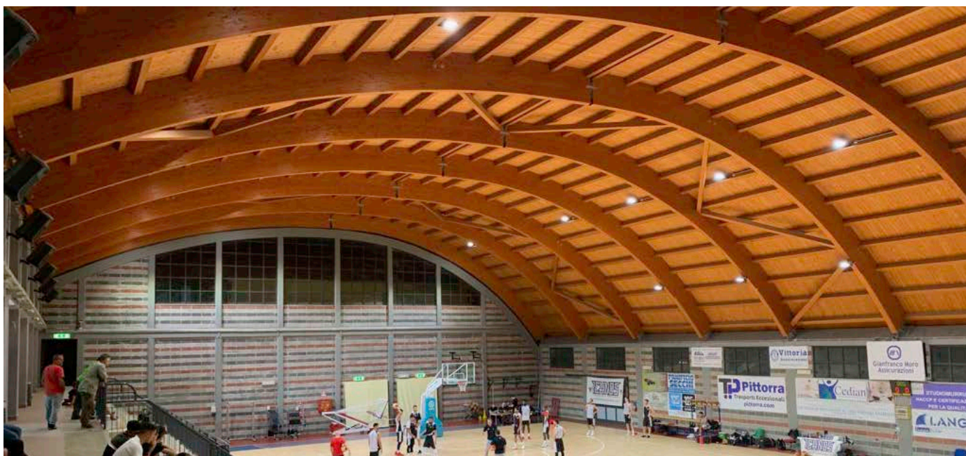
Interno della palestra del Comune di Nuoro (Italia) illuminata con i FLOODLIGHT LEDVANCE
