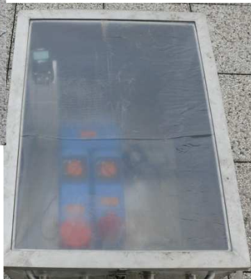
Contenitore saturo di idrogeno con quadro TAIS-EX
