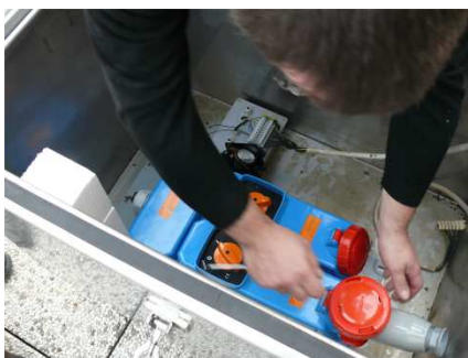
Apertura del contenitore e registrazione della percentuale di idrogeno
