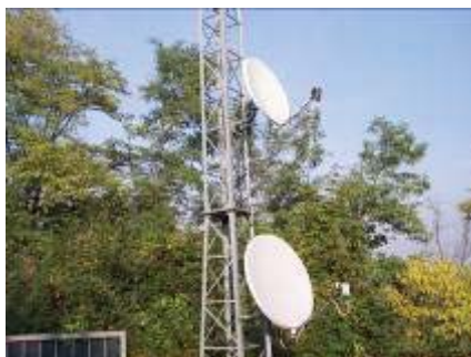
Figura 8.37 – Esempio di traliccio per il sostegno di parte aerea per la ricezione di segnali radioelettrici utilizzato anche per l'ancoraggio di parabole per la ricezione dei segnali provenienti da satelliti.
