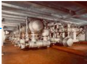
Disjuntor isolado a gás
