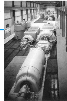
Turbina a gás
