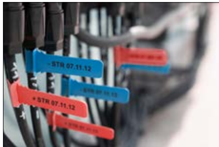
TAGPU LOOP - Identificação de cabos no inversor.
