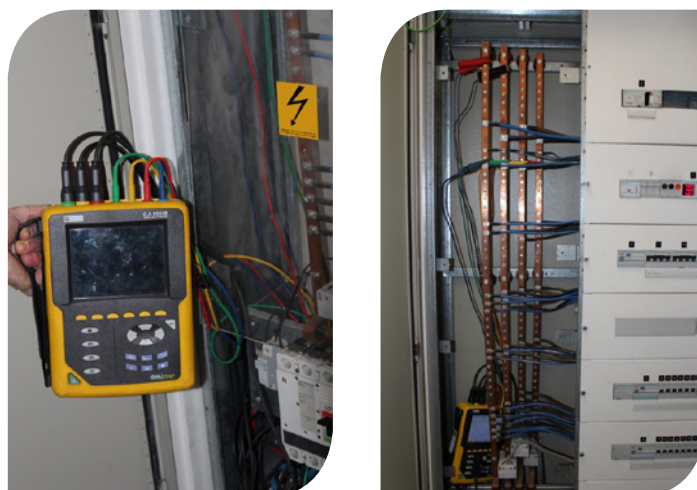
Figura 3 Ligação do analisador de energia no Quadro Principal do edifício MercoAlcobaça.
