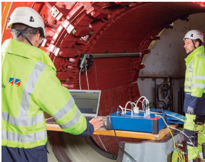
Figura 1. Em desligamentos de manutenção mais longos, o teste de imperfeição eletromagnética é realizado off-line com o equipamento de teste multifuncional CPC 100 da OMICRON e o upgrade para medição do núcleo do estator opcional.
