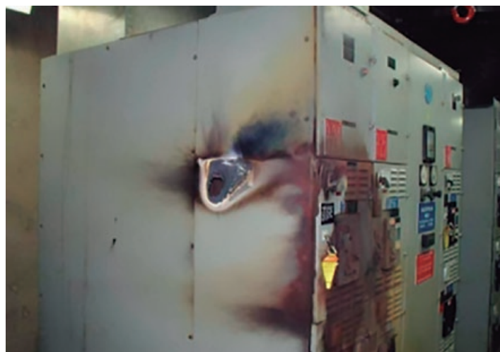
Figura 3. Quadro eléctrico após um arc flash .
