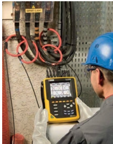
Figura 6. Medição de Qualidade de Energia. Fonte: Chauvin Arnoux.
