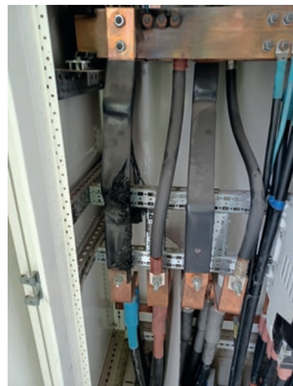
Figura 4. Quadro Danificado por Sobreaquecimento.
