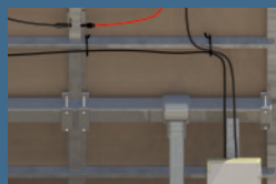
② Instalação BT DC entre painéis e caixas de ligação (string combiner box)
