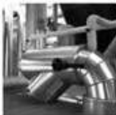
Aplicação de ar condicionado
