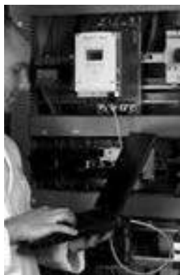
Comissionamento do arrancador progressivo ATS 22 através do software SoMove Lite
