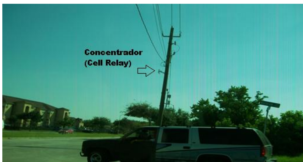
Figura 9.8: Concentrador instalado em campo.
