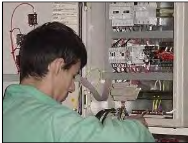
Fig. 2.5. Trabalho em oficina - quadros elétricos.
