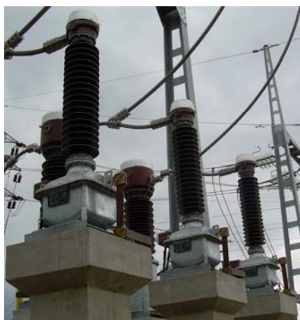
Figura 3: Transformador de Tensão.
