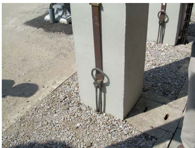
Figura 5: Ligação à rede terra das partes metálicas.
