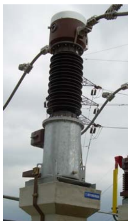
Figura 4: Transformador de Intensidade.
