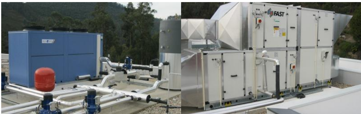
(a) Chiller/bomba de calor
