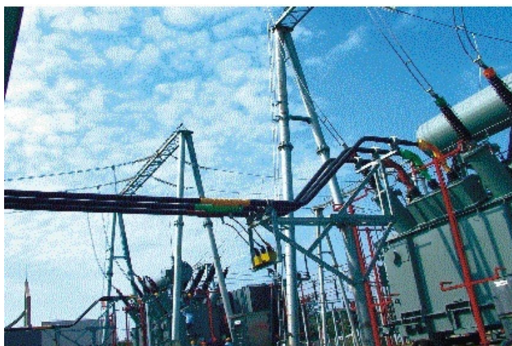
Figura 2.2- Condutores rígidos numa subestação
