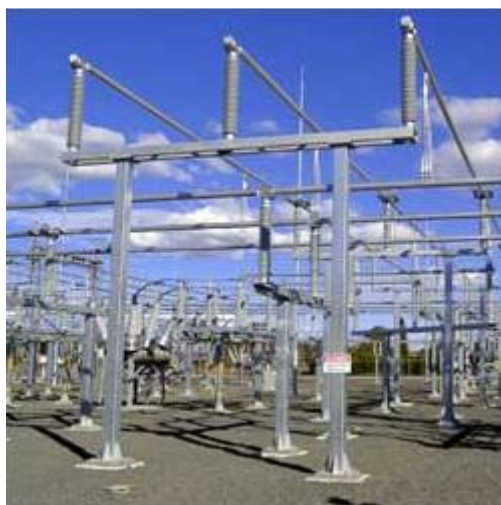
Figura 2.1 - Condutores rígidos numa subestação
