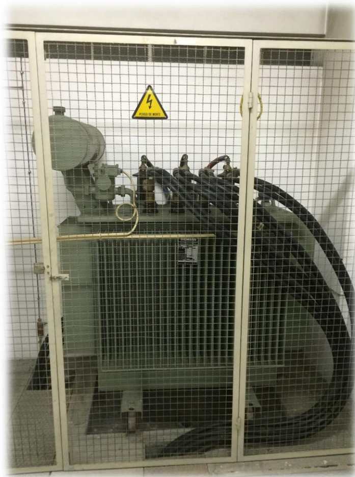
Figura A.5 - Transformador nº LEL 46520
