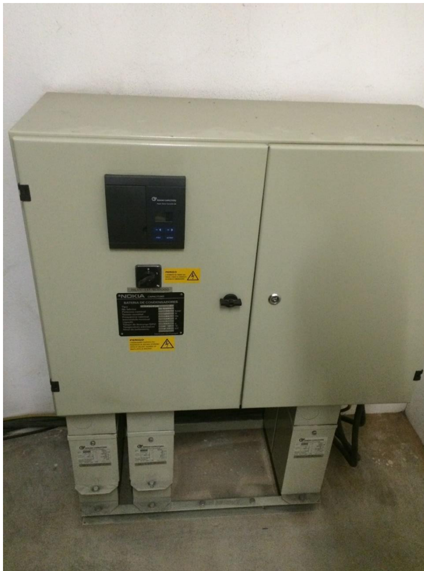
Figura A.7 - Bateria de condensadores do edifício DEEC
