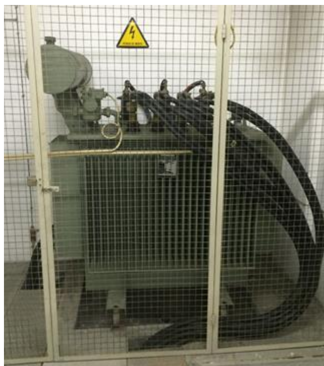
Figura 4 - Transformador principal do PT do edifício DEEC
