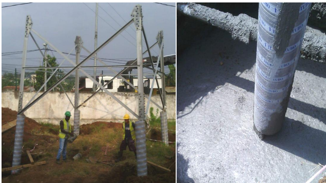
Figura 9 – Base de um apoio de uma linha aérea (esquerda) e pormenor de encastramento de um “pé” no maciço (direita)
