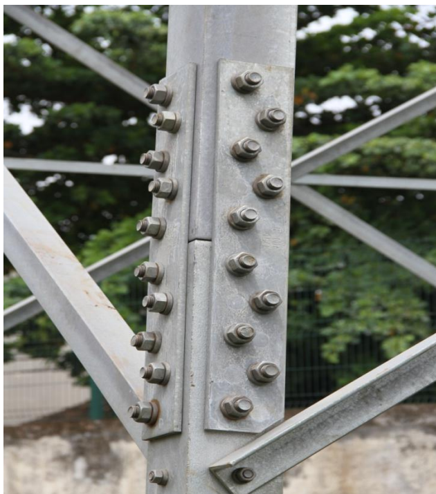
Figura 8 – Pormenor de fixação de duas secções de um apoio de uma linha aérea
