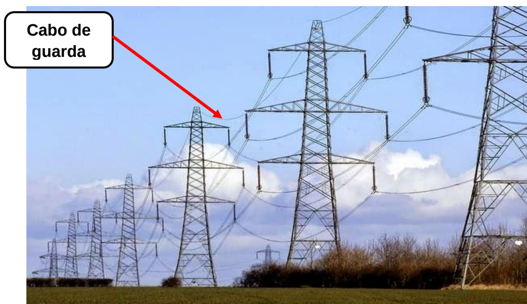
Figura 38 – Cabos de guarda
