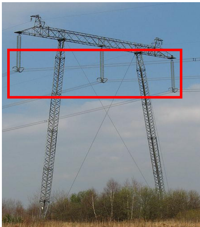
Figura 3 – LMAT com um circuito e disposição em esteira horizontal
