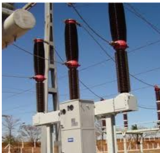
Figura 8 – Disjuntor de pequeno volume de óleo
