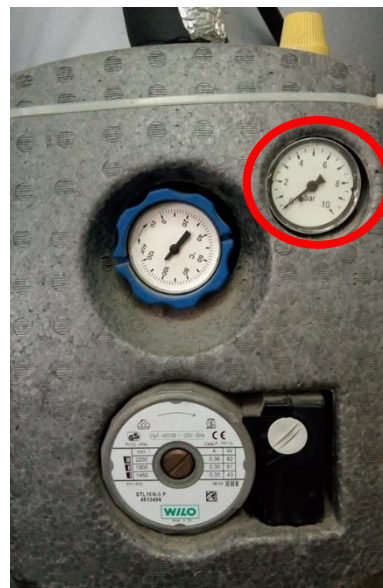
Pressão Baixa no Circuito Primário de um Sistema Solar Térmico
