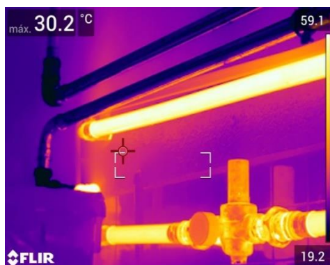
Falta de Isolamentos térmicos em tubagens de AQS
