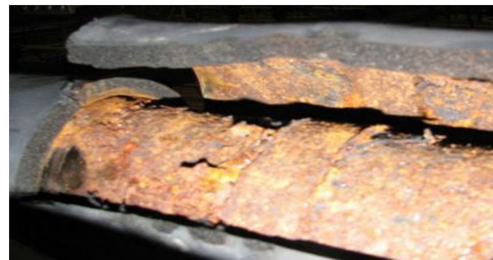
Corrosão em Tubagens de AQ.
