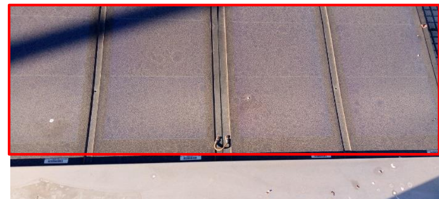
Falta de Limpeza– Sistema Fotovoltaico
