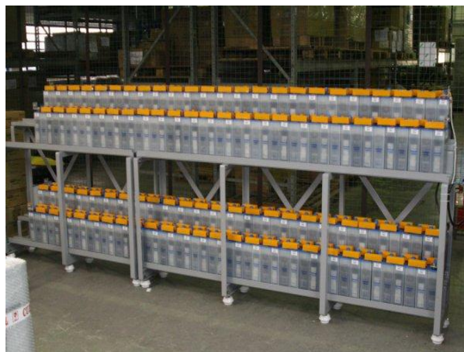
Figura 4 – Bateria em estantes
