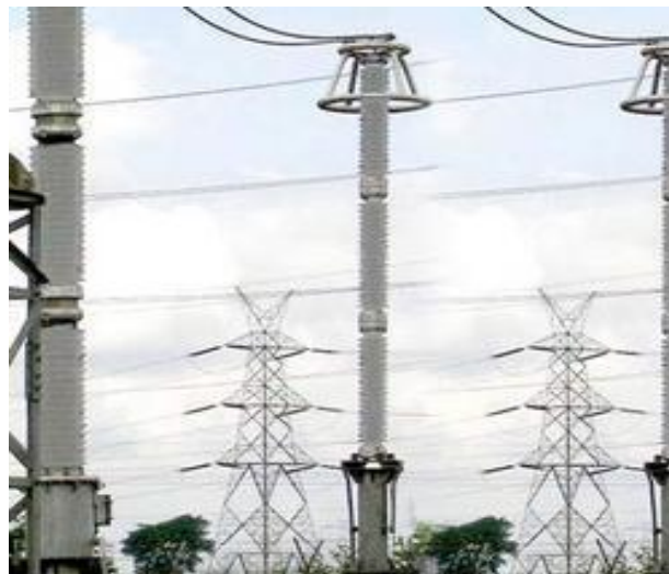
Figura 24 – Descarregador de sobretensões
