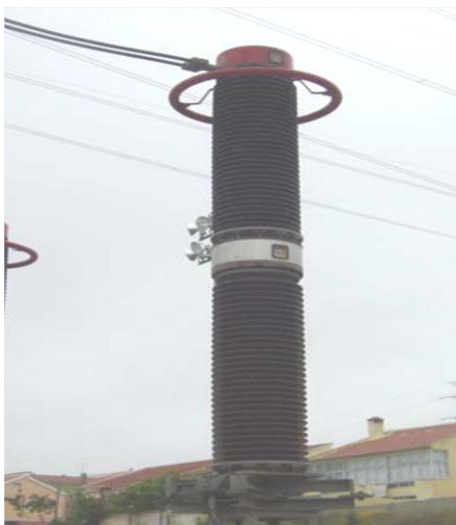
Figura 11 – Transformador de medida de tensão
