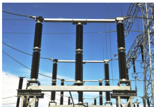
Figura 8 – Seccionador rotativo (de três colunas) de corte horizontal
