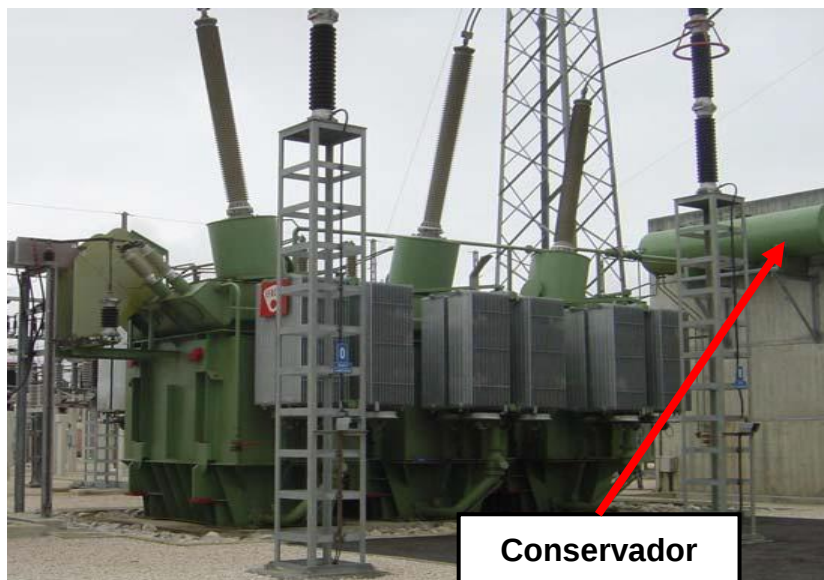
Figura 1 – Transformador com conservador
