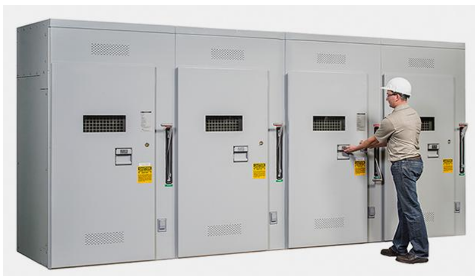
Figura 27 – QMT do tipo Metal Clad
