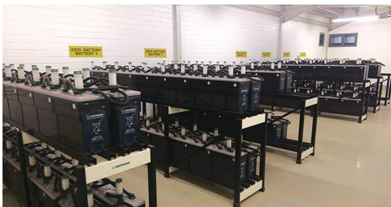
Figura 20 – Baterias em estante
