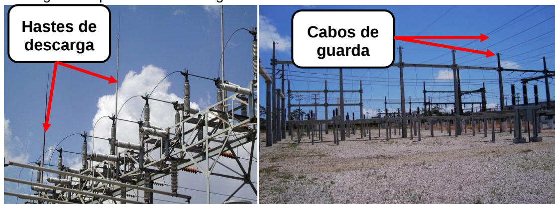
Figura 7 – Hastes de descarga e cabos de guarda (esquerda) e cabos de guarda (direita)
