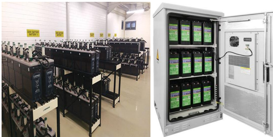
Figura 6 – Baterias em estante (esquerda) e em armário (direita)
