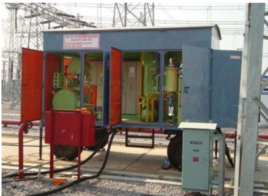
Figura 9 – Equipamento de filtragem e tratamento de óleo
