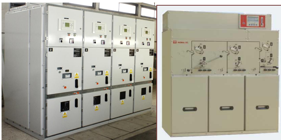
Figura 5 – Quadro de Média Tensão do tipo “Metal-Enclosed” (esquerda) e do tipo RMU (direita) de um PT de cabina baixa
