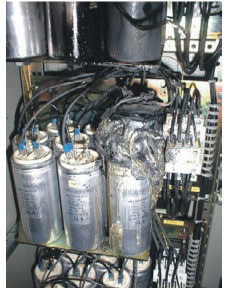
Abb.: Zerstörte Kondensatoren durch Oberschwingungen
