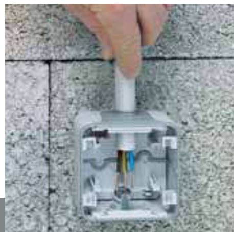
3/ A membrana do bucim ajuda a nivelar eixo do tubo e garante o IP 55 da instalação
