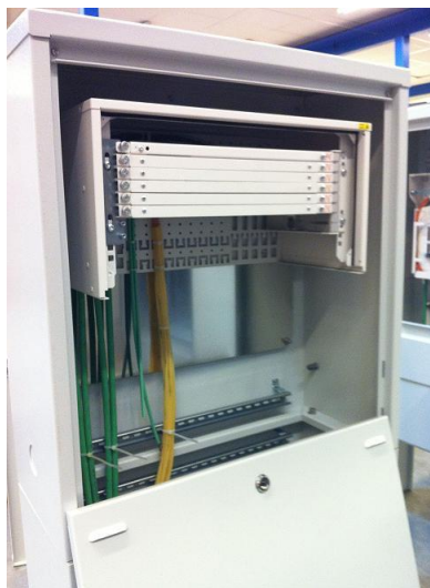
NS8+ Monterad i ett Rittal markskåp
