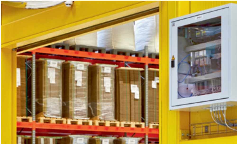
AXC Cloud-Pro kontrolörü ve hizalı I/O modülleri veriyi depolama odalarına dağıtılmış sıcaklık sensörlerinden toplar
