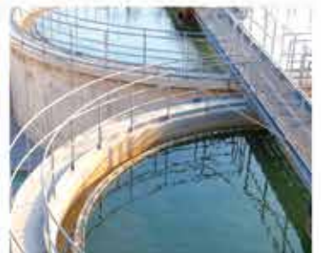
Su / Atık su
